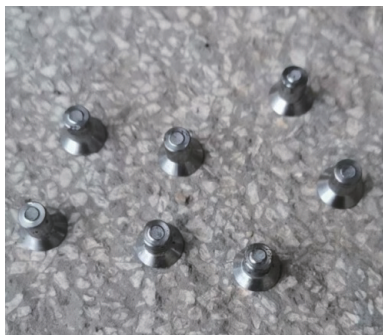
图7 方案a螺栓断裂情况
